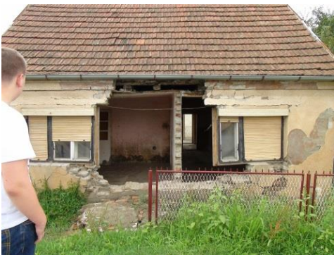
Von den Fluten zerstörte Häuser in Doboj
